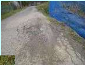
陥没している農道
