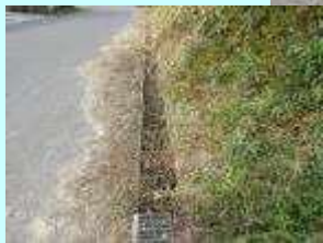
土砂が堆積した水路
